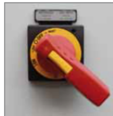
HAUPTSCHALTER gemäß VDE im Anbau- schaltschrank installiert
